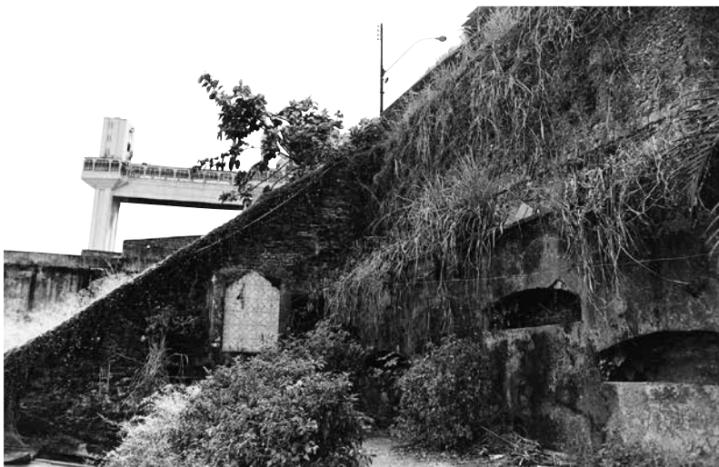
19. Ruína dos carneiros da Igreja de Conceição da Praia, Salvador.
